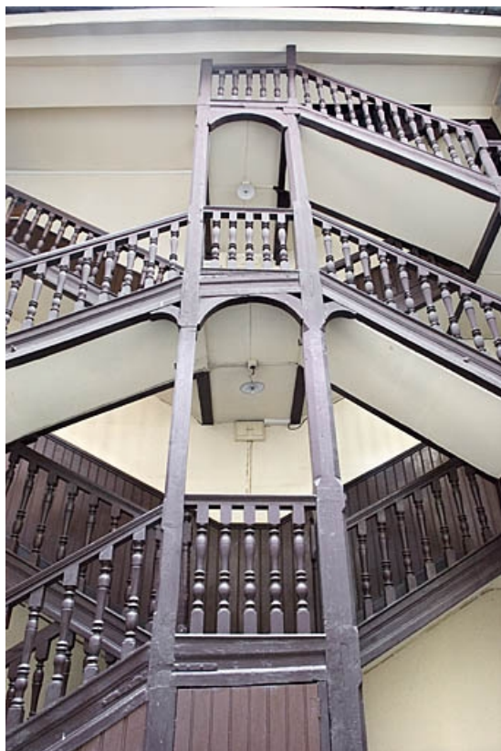
Vue d'ensemble de l'escalier à cage ouverte de face. 25, Besançon, 16 rue Ronchaux, lieudit : îlot Granvelle
