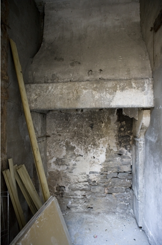
Détail de la cheminée d'une cuisine située dans l'aile droite de la deuxième cour. 25, Besançon Grande Rue 122, lieudit : îlot Granvelle
