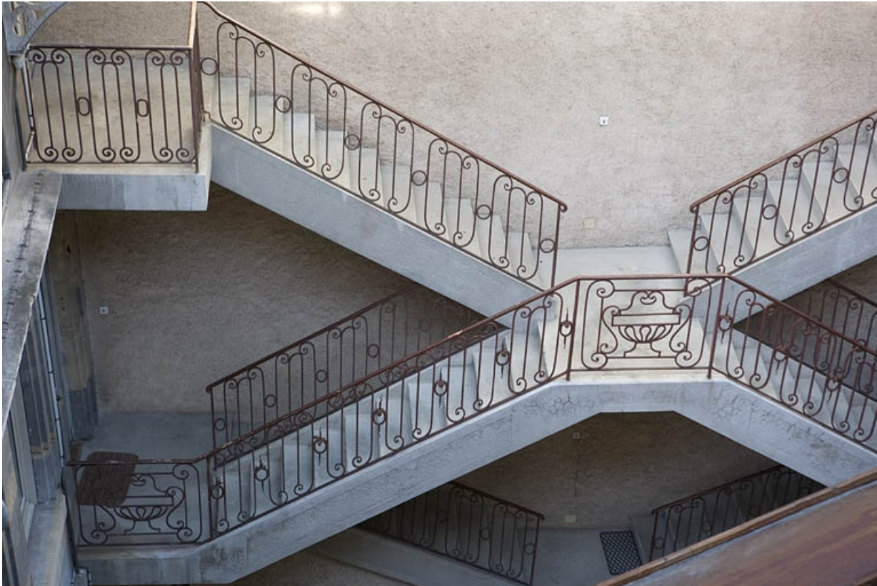
Détail de la rampe en fer forgé de l'escalier à cage ouverte, depuis la parcelle voisine. 25, Besançon Grande Rue 122, lieudit : îlot Granvelle
