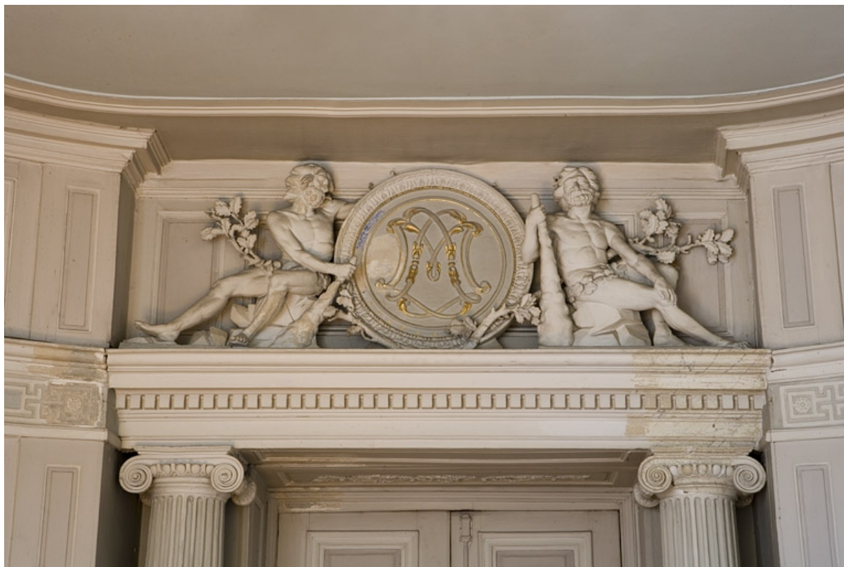
Hôtel en fond de cour, antichambre : détail du dessus de la porte menant au grand salon.
