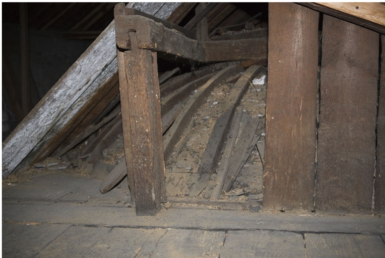
Hôtel en fond de cour : extérieur de la fausse-coupole de l'escalier situé dans le grenier.
