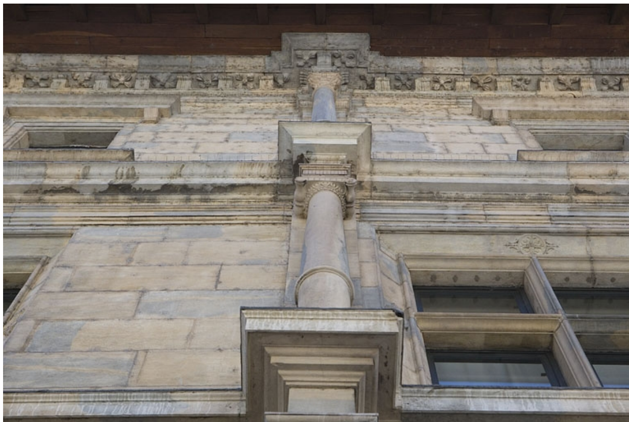
Façade principale : détail de deux colonnes ionique et composite superposées, en contre-plongée.
