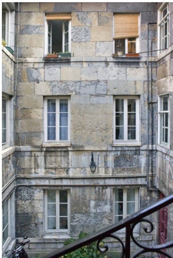
Détail de la façade en fond de cour depuis l'escalier à cage ouverte. 25, Besançon, 1 rue de la Vieille Monnaie, lieudit : îlot Ronchaux
