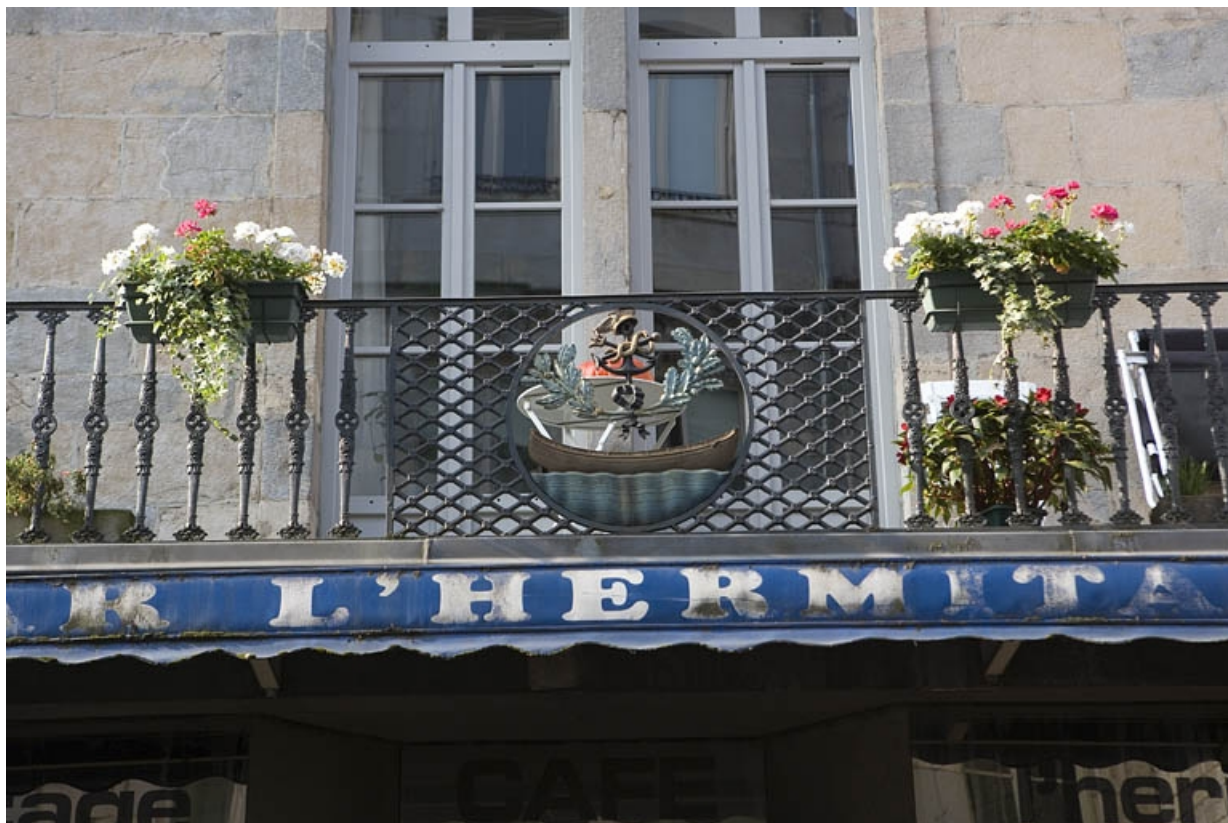
Détail du balcon sur la partie centrale de la façade sur rue, de face.
