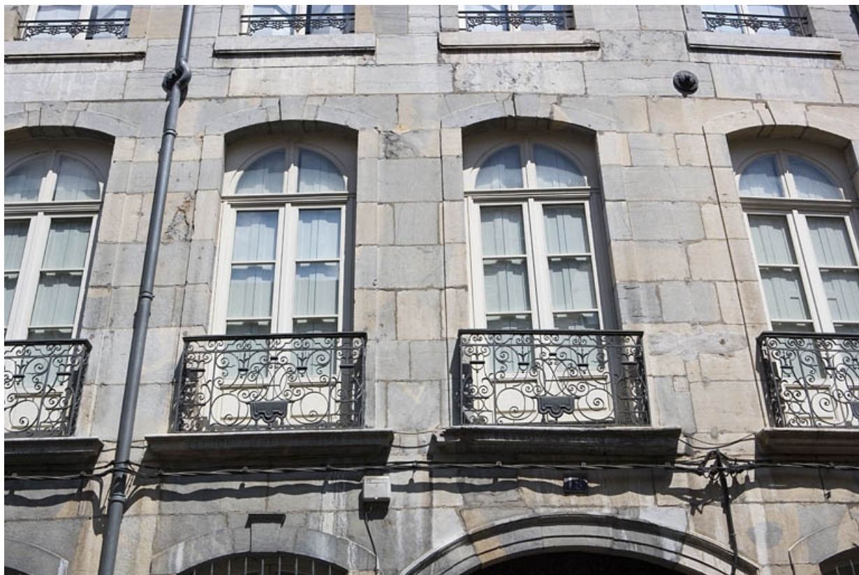
Logis principal : détail des garde-corps des fenêtres du premier étage sur rue. 25, Besançon, 19 rue Mégevand, lieudit : îlot Terrier de Santans
