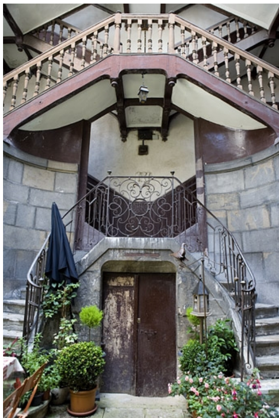
Détail de la partie inférieure de l'escalier à cage ouverte avec l'entrée de cave. 25, Besançon, 5 rue Mégevand, lieudit : îlot Terrier de Santans
