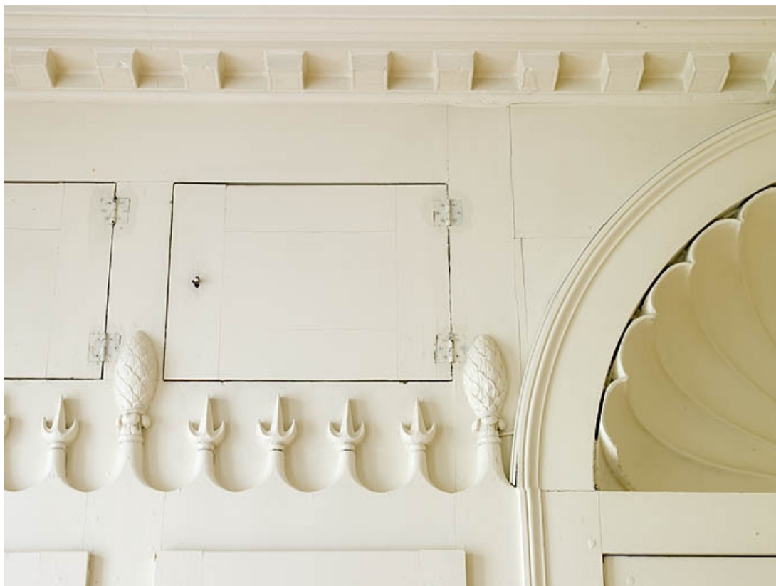
Logis principal, intérieur, salle à manger : détail du décor des lambris à côté de la porte d'entrée. 25, Besançon, 27 rue Mégevand, lieudit : îlot Terrier de Santans
