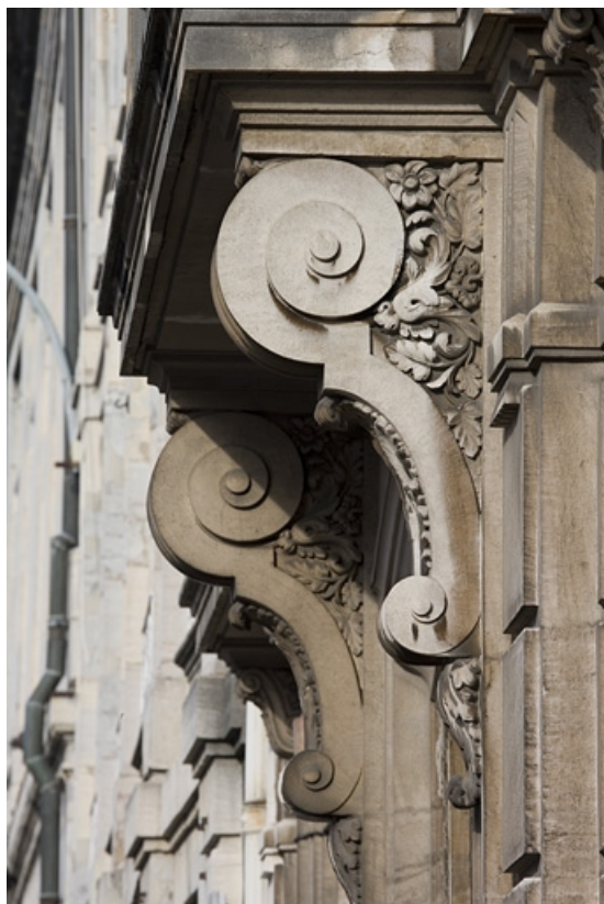
Détail des supports en forme de volutes soutenant le balcon du premier étage. 25, Besançon, 9, 9 bis rue Charles Nodier, lieudit : îlot Banque de France
