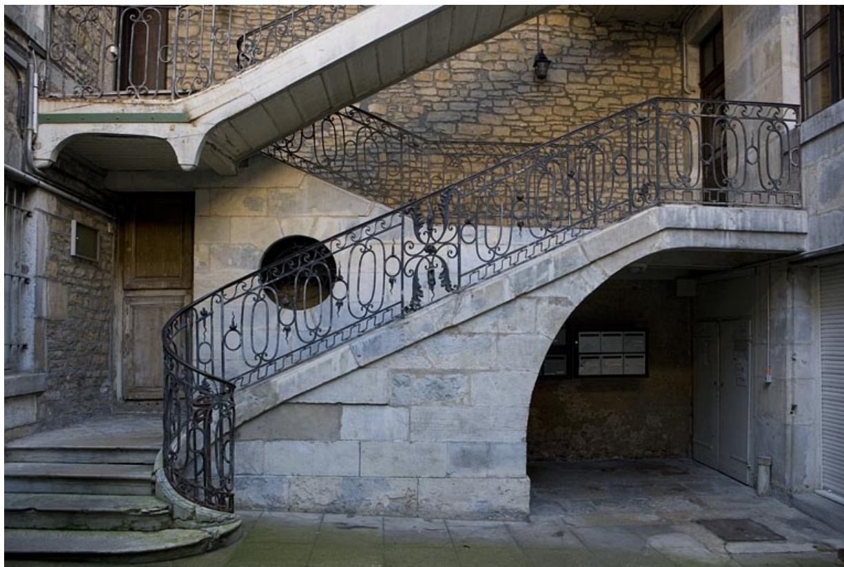
Détail de la première volée de l'escalier à cage ouverte depuis la cour.
