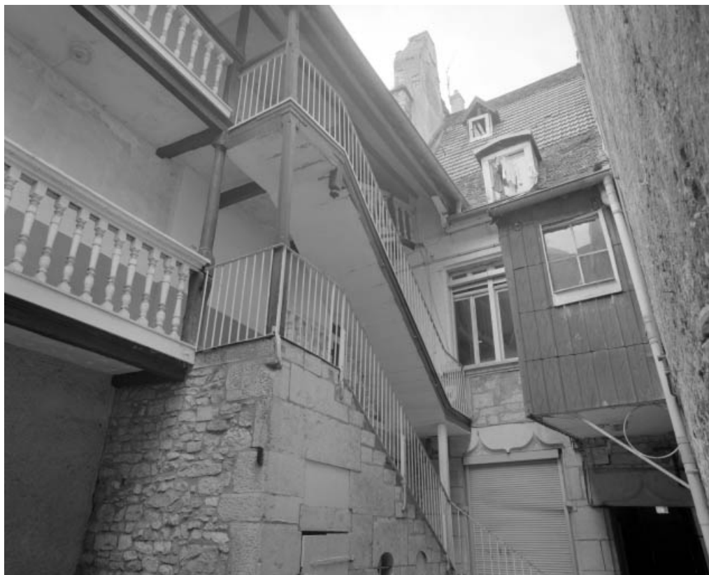
Détail de l'escalier et de la coursière depuis le fond de la cour.
