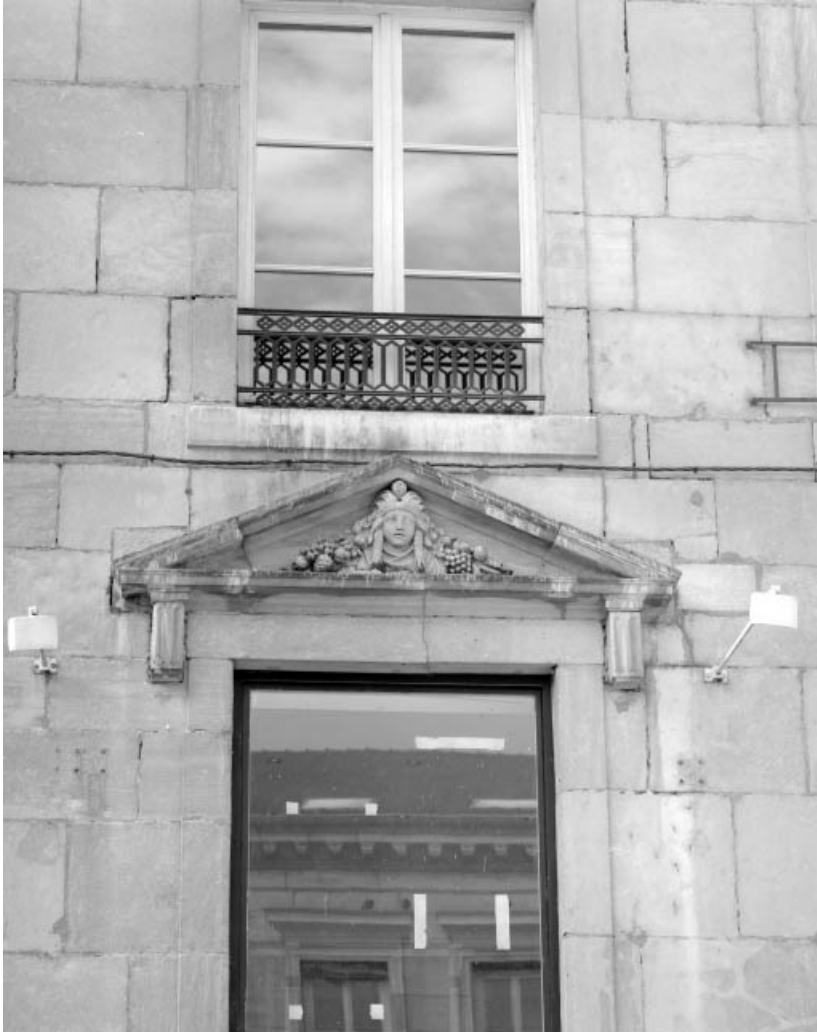
Façade sur rue, détail du fronton sur la baie centrale de la partie droite. 25, Besançon, 6 rue Pasteur, lieudit : îlot Pasteur
