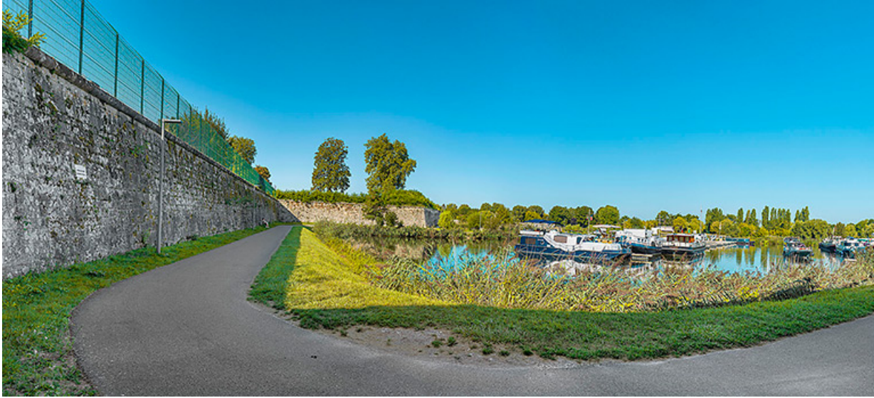
La courtine reliant les bastions Royal et du Béchaux, le port de plaisance et le bastion en arrière-plan. 21, Auxonne, 2 rue Mignotte
