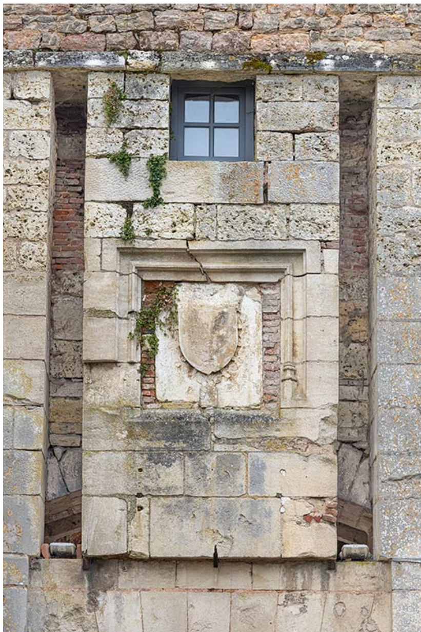
Porte côté ville : détail du blason et des rainures des flèches du pont-levis. 21, Auxonne, 1 rue du Château
