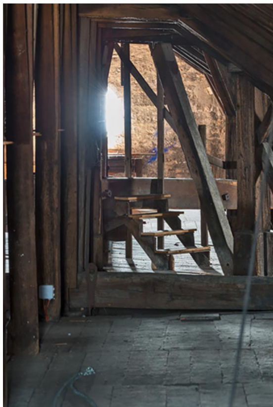
Comble : croisée du transept, avec le chevet oriental au fond. 21, Dijon, 15 rue Danton
