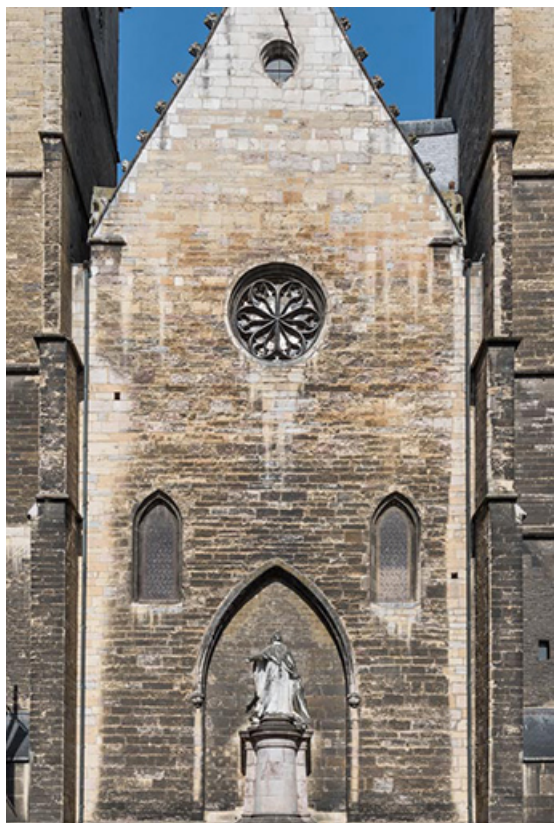
Façade orientale : mur fermant la travée droite du choeur disparu. Au centre, le monument à Bossuet. 21, Dijon, 15 rue Danton
