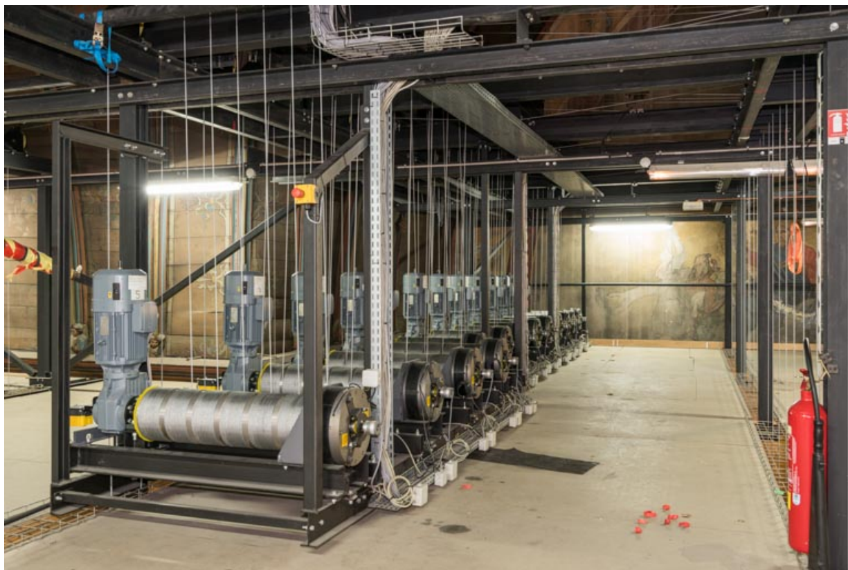
Croisée du transept : cintres du théâtre, avec les moteurs des équipes. 21, Dijon, 15 rue Danton
