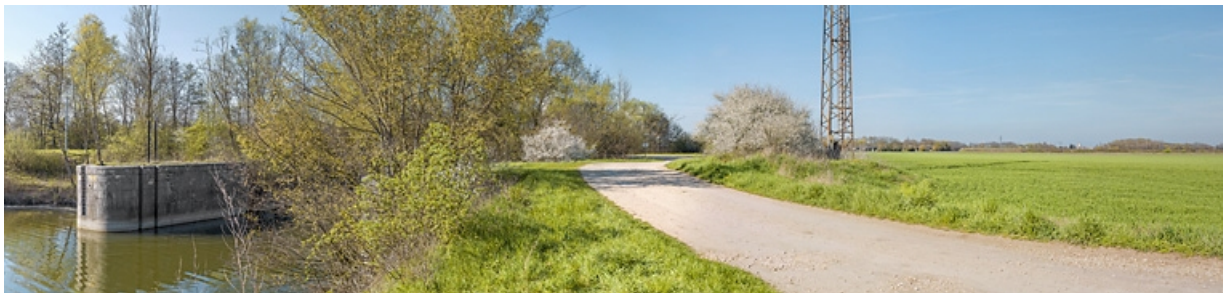
Les vestiges de l'ancien barrage de Saint-Jean-de-Losne : pile du pertuis avec "rainures à poutrelles".
