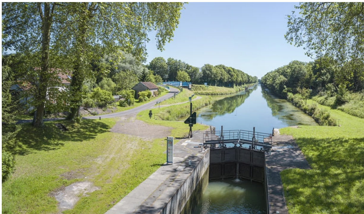
Vue des portes amont et du sas depuis le pont sur écluse.
