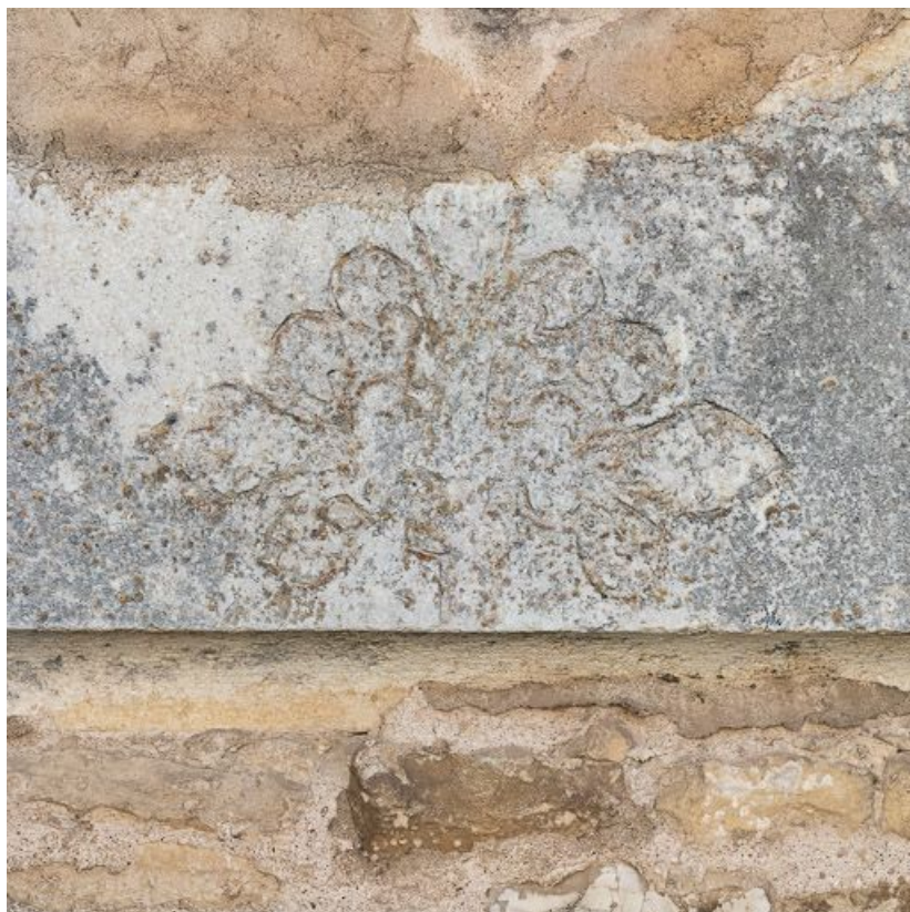
Linteau de la porte latérale gauche murée.
