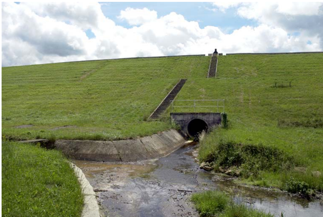
Décharge de fond au centre de la digue principale ; sortie de la digue.
