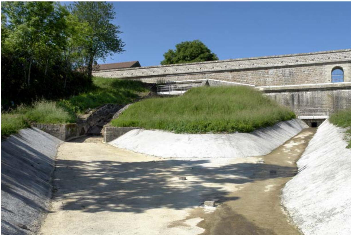
Rigole de décharge du déservoir de superficie qui rejoint celle de la tour de prise d'eau et de la vanne de fond. 21, Rouvres-sous-Meilly, lieudit : le Tillot
