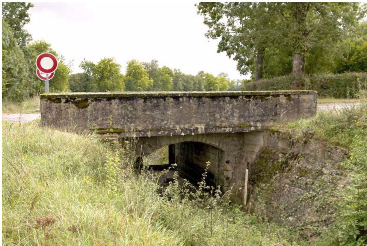
Pont routier sur la rigole de prise d'eau dite "rigole de Beaume", vue aval. 21, Chazilly, lieudit : Chazilly
