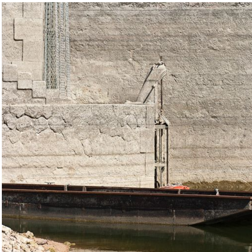
Détail de la vanne de la tour de prise d'eau. 21, Pont-et-Massène, lieudit : Pont-et-Massène
