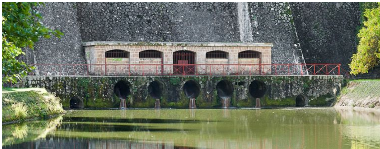
Vue extérieure de la chambre des robinets située en contrebas de la digue.
