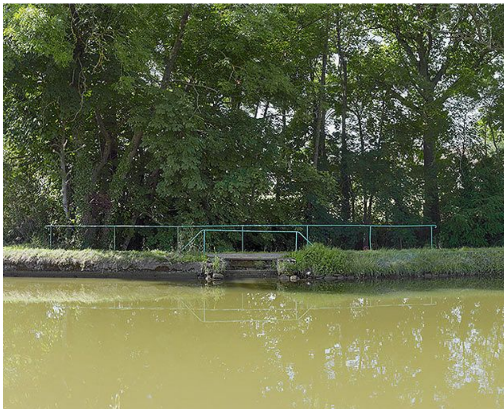
Vue du garde-corps de l'entrée de la Vandenesse sous le canal rive droite.
