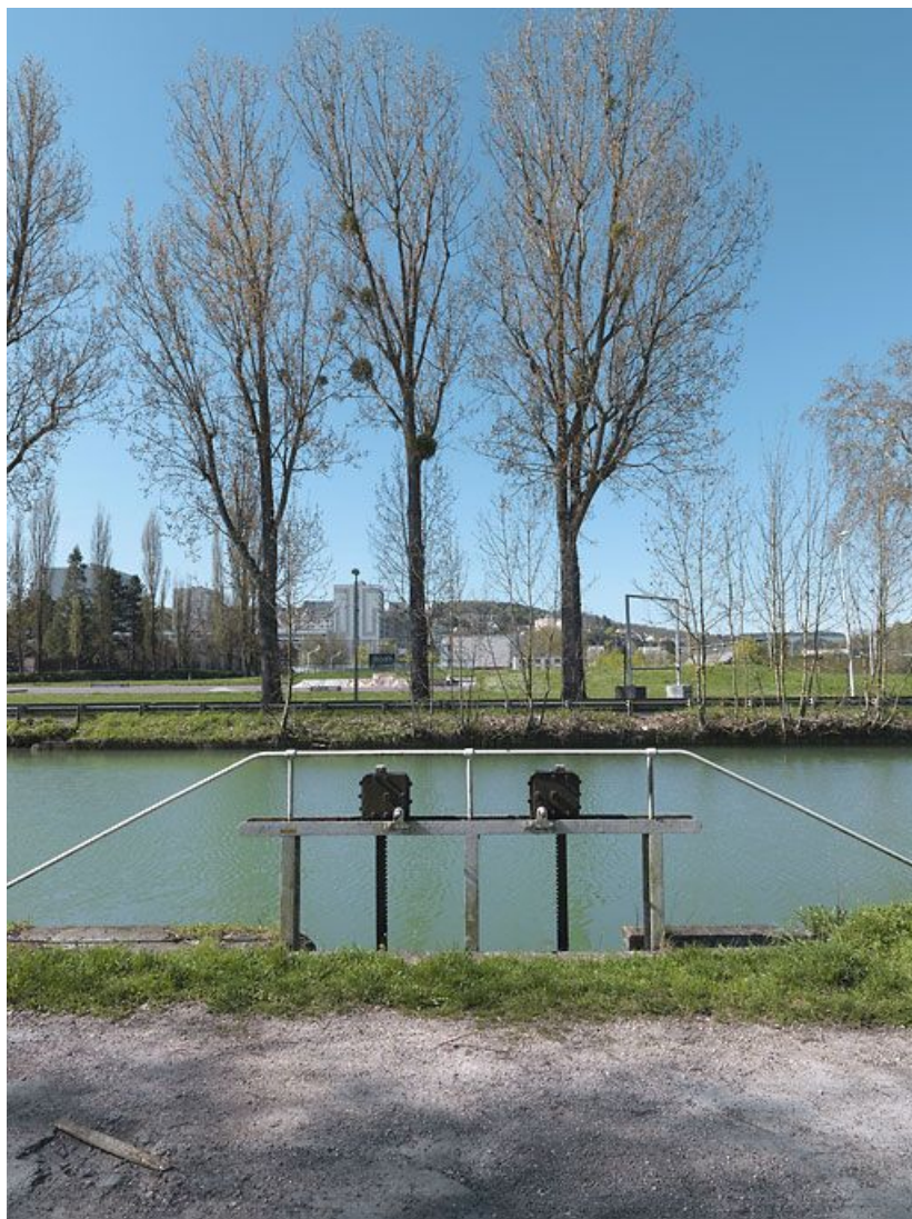
Déversoir du canal dans l'Ouche : vannes.
