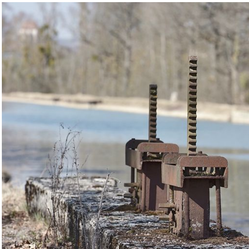
Sortie de l'aqueduc de Beurisot : détail des deux vannes.
