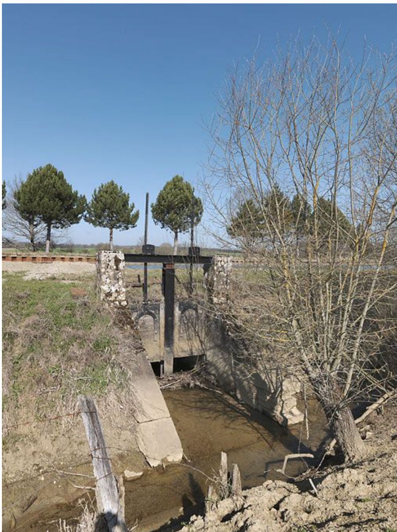
L'aqueduc-déversoir avec ses vannes passant sous le canal en amont du site d'écluse 16. 21, Charigny, lieudit : bief 16 du versant Yonne
