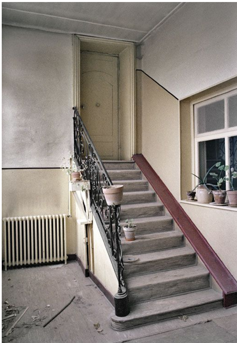
Immeuble en retrait sur la rue, avant travaux : escalier de la galerie postérieure menant au rez-de-chaussée surélevé de l'aile ouest. 21, Saint-Jean-de-Losne place d' Armes
