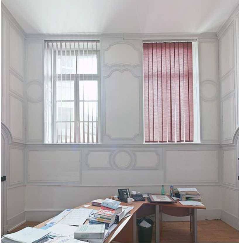
Aile droite : pièce du rez-de-chaussée, actuellement bureau de la directrice. 21, Saint-Jean-de-Losne place d' Armes
