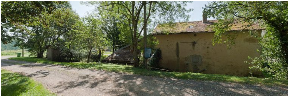
Vue de la façade arrière de la maison éclusière et du jardin.
