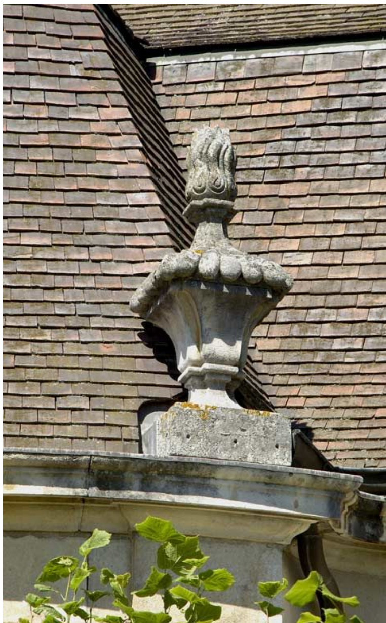
Aile droite : travée de la chapelle, pot à feu. 21, Semur-en-Auxois, 7 rue de l' Hôpital
