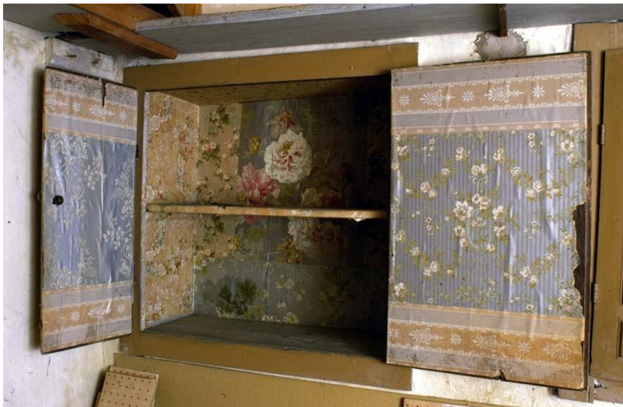
Ancien hôtel du gouverneur : pièce dite laboratoire, détail : intérieur du premier placard mural gauche. 21, Semur-en-Auxois, 7 rue de l' Hôpital
