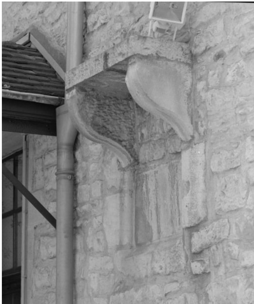
Bâtiment dit de l'administration, détail : consoles encore en place dans le mur postérieur. 21, Nuits-Saint-Georges Henri-Challand
