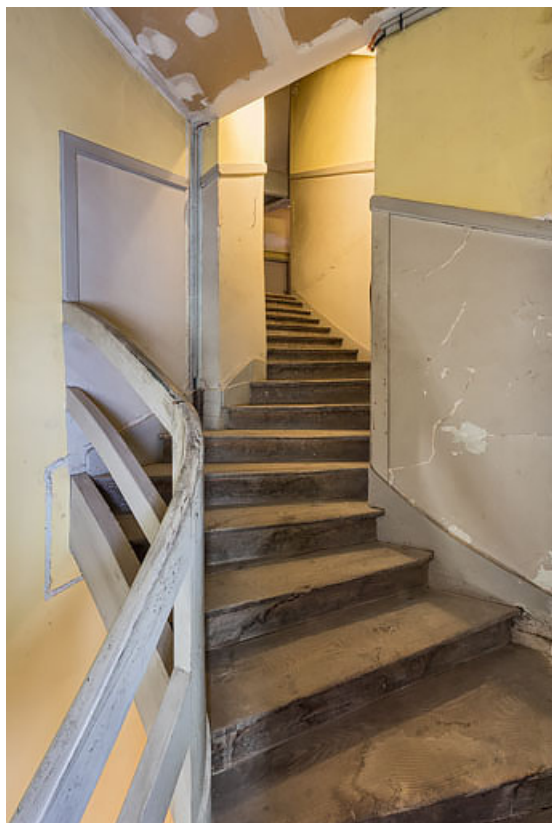
Escalier conduisant au 3e balcon (côté cour) : jonction entre le corps d'entrée et le corps principal. 21, Beaune, 64 rue de Lorraine
