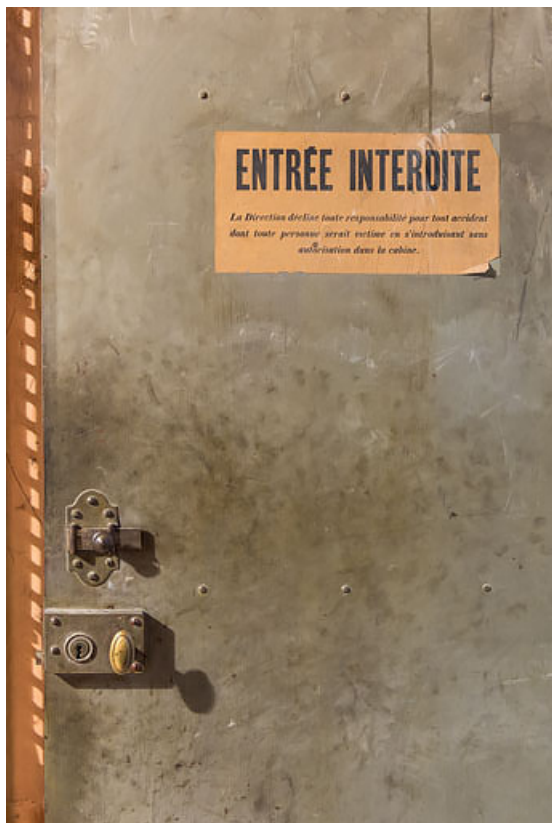
Entrée de la cabine de projection, côté jardin : détail. 21, Beaune, 64 rue de Lorraine
