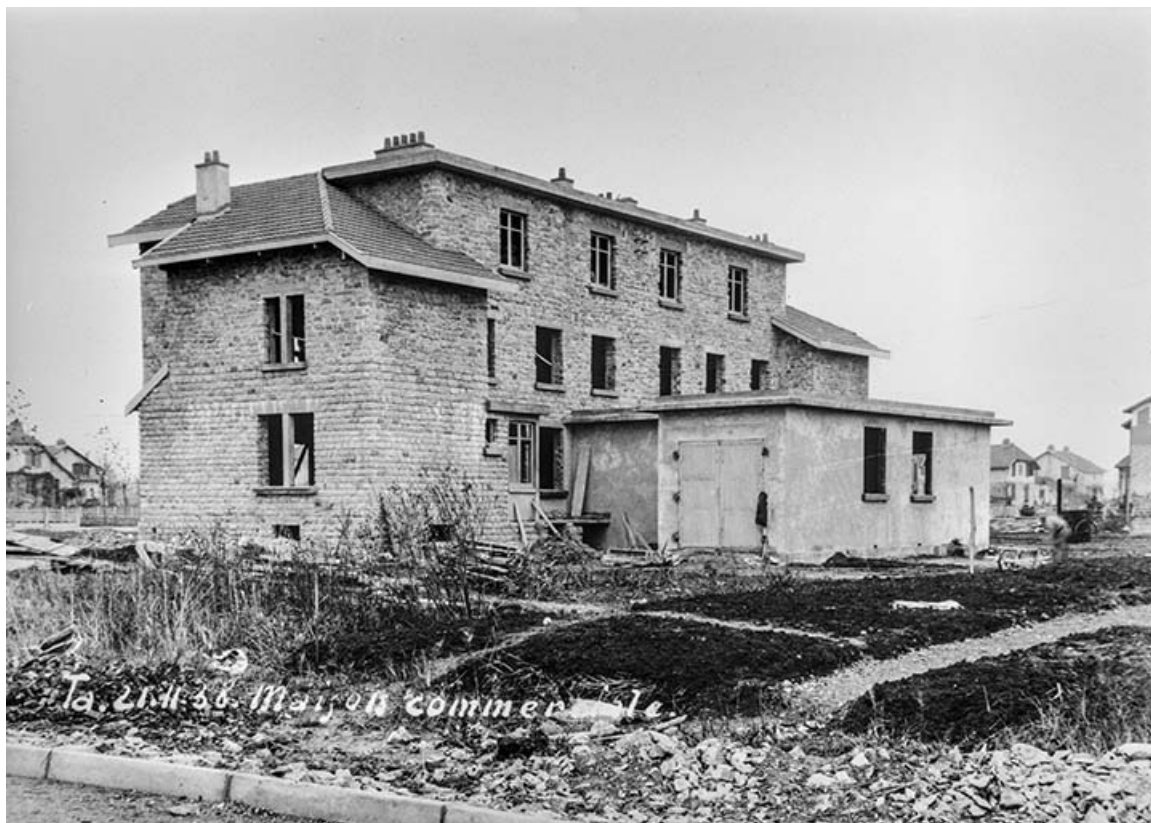
Travaux de construction de l'immeuble avec boutiques, 2 place de la Victoire, façade postérieure et face droite. 39, Tavaux, lieudit : Tavaux Cité
