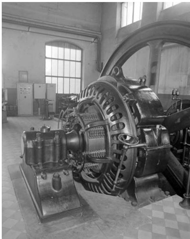
Salle des machines (10) : dynamo Schneider et Cie. 39, Dole, 65 rue de Crissey
