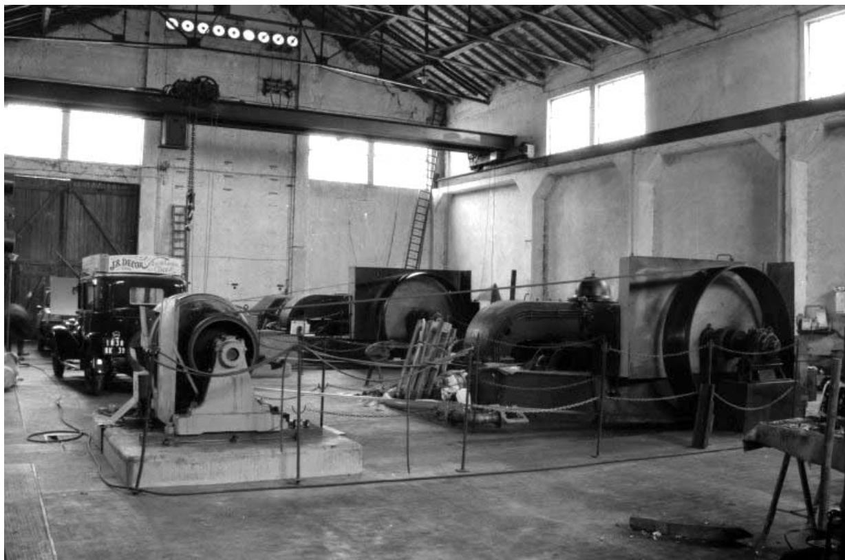
Centrale hydroélectrique, intérieur : transmission de la turbine et alternateur.
