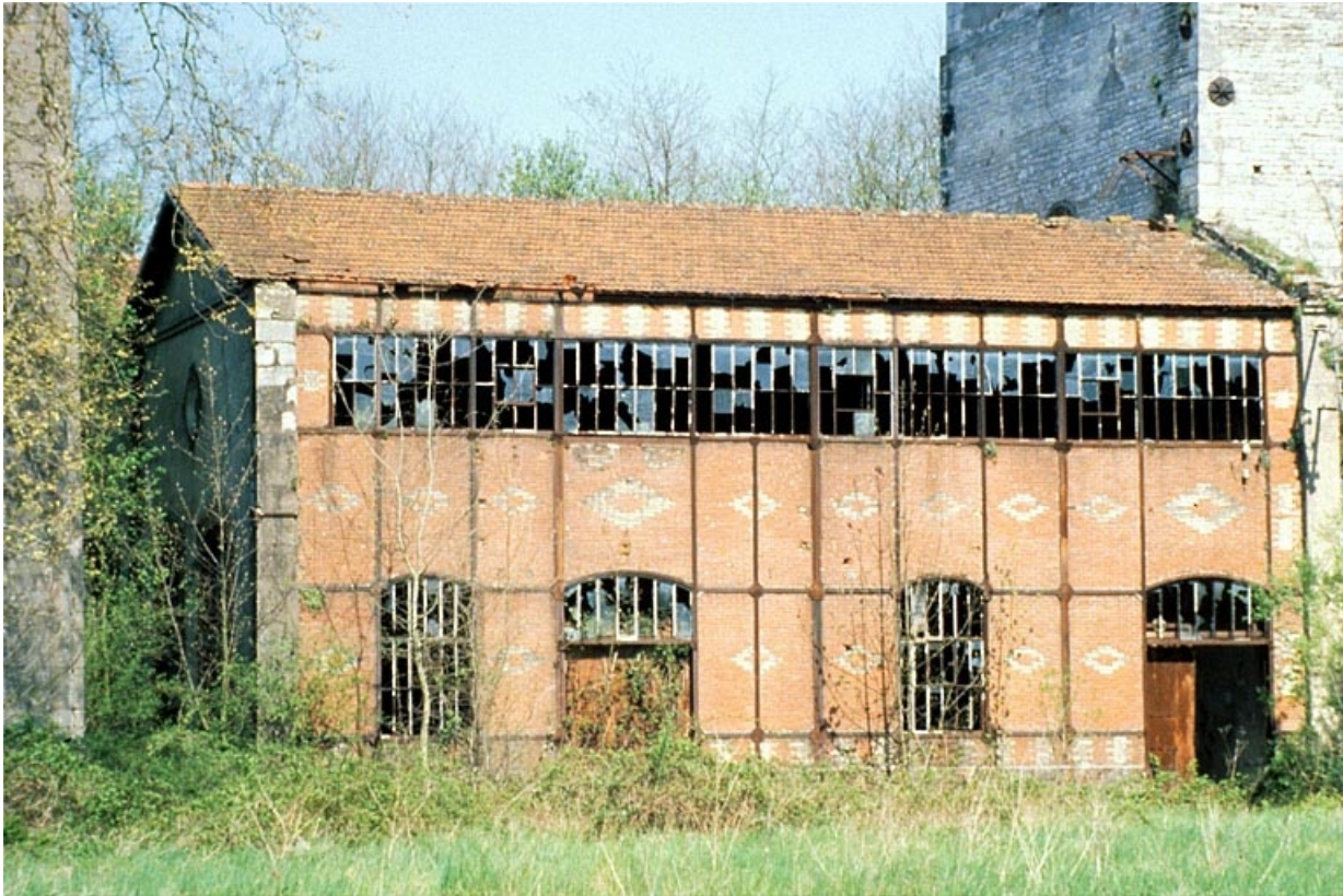
Forge Neuve. Centrale électrique : façade antérieure de la salle des machines (J). 39, Fraisans rue de la Gare
