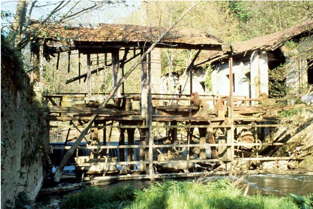
Vieille Forge. Bâtiment d'eau dit le Sénat : salle des turbines vue du canal de fuite. 39, Fraisans rue de la Gare
