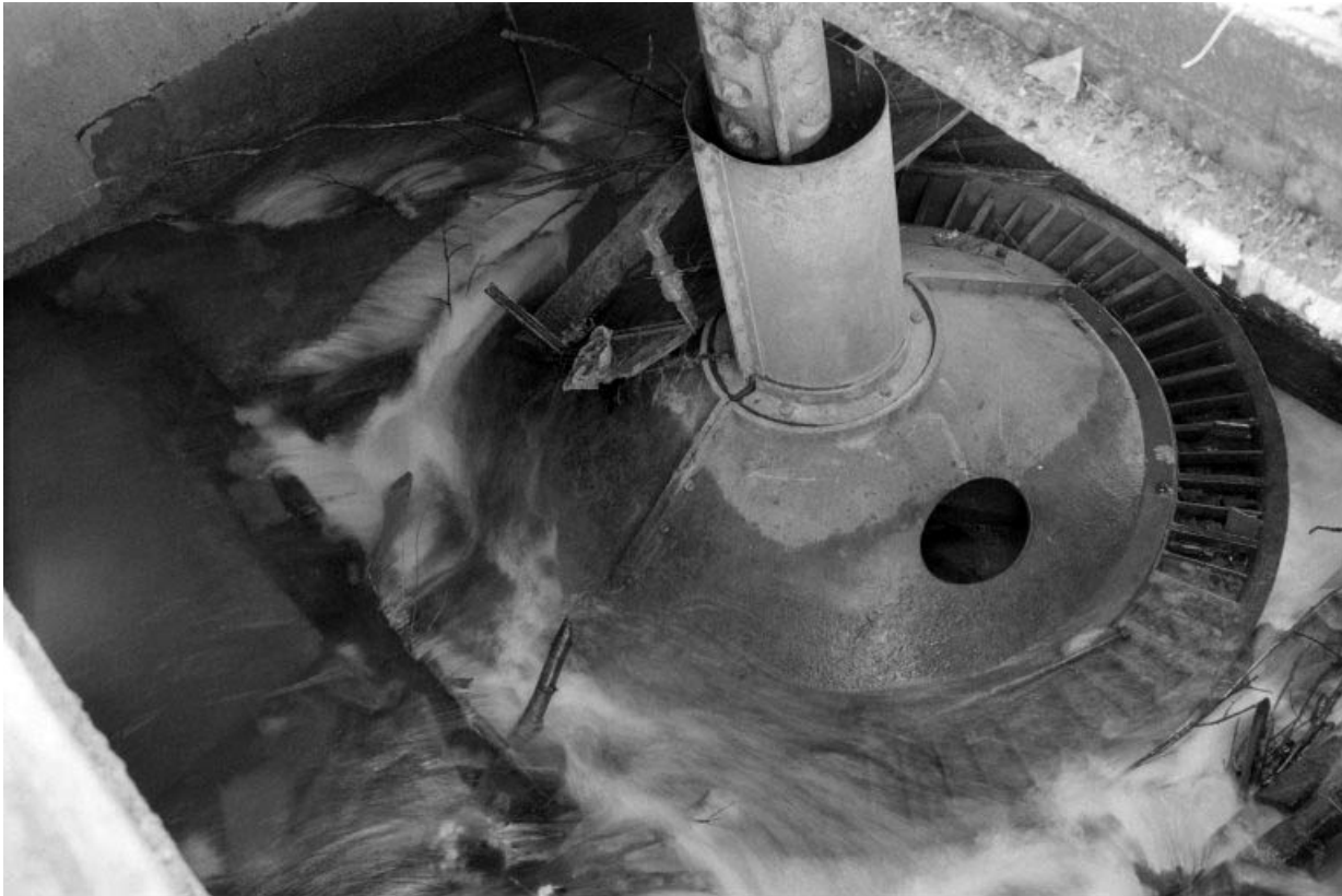
Forge Neuve. Bâtiment d'eau (L) : partie supérieure de la turbine. 39, Fraisans rue de la Gare
