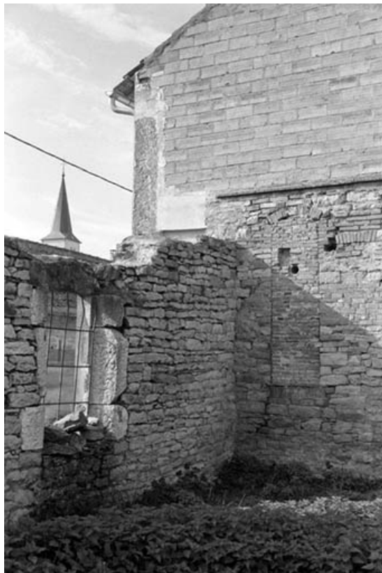
Baie murée, vestige d'un four.
