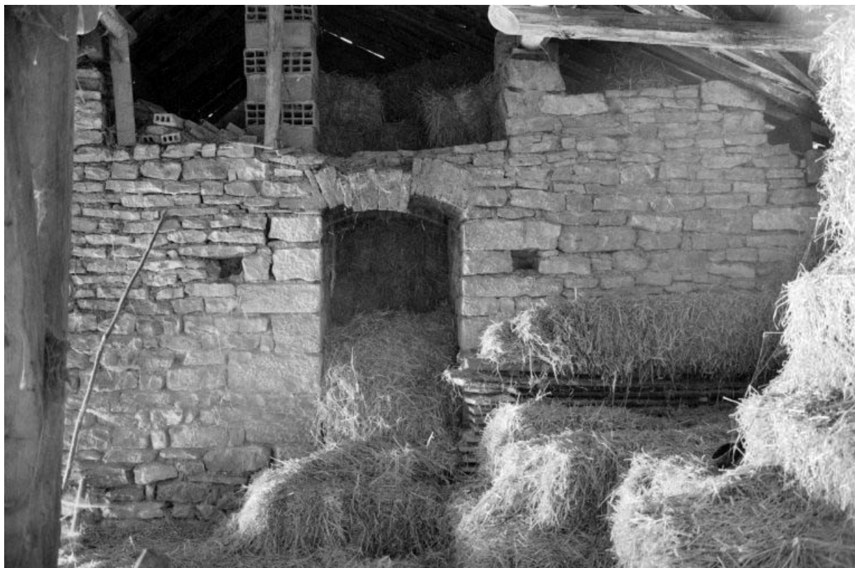
Porte d'enfournement du 2e four (four intérieur).
