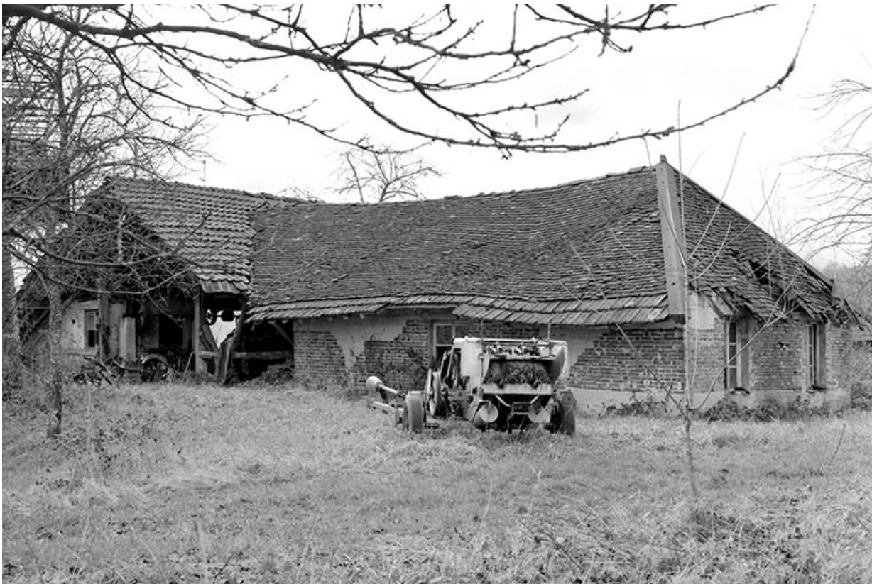
Atelier de fabrication et pièce de séchage : extrémité orientale. À gauche sous la halle, pièce contenant le moteur Bernard et sa transmission.
