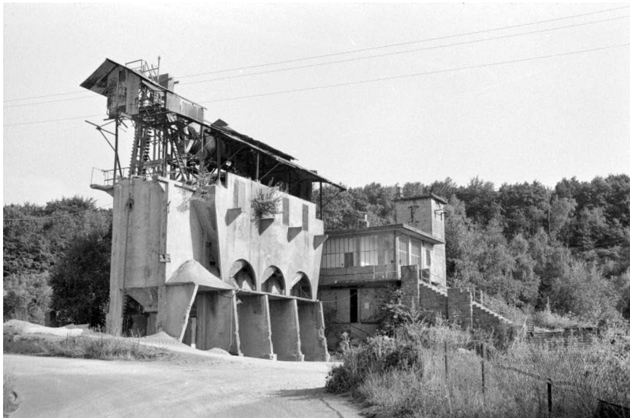
Poste de lavage (C) et poste de surveillance (D) vus depuis le nord.
