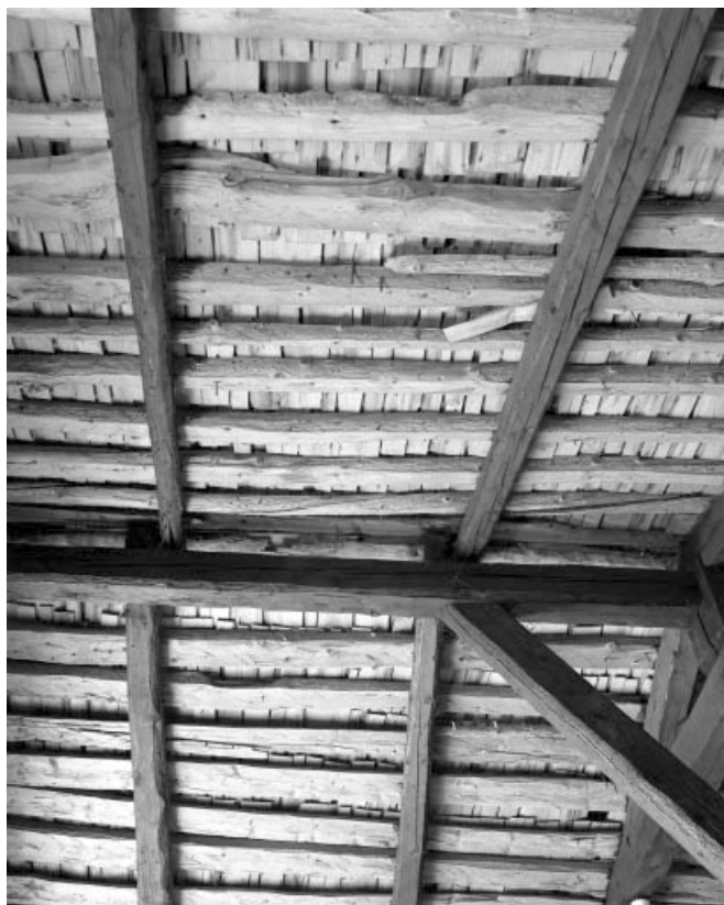
Détail de la couverture depuis la grange haute : les tavillons sont encore posés sous la couverture en tôle actuelle. 39, Les Moussières, lieudit : au Montechoux
