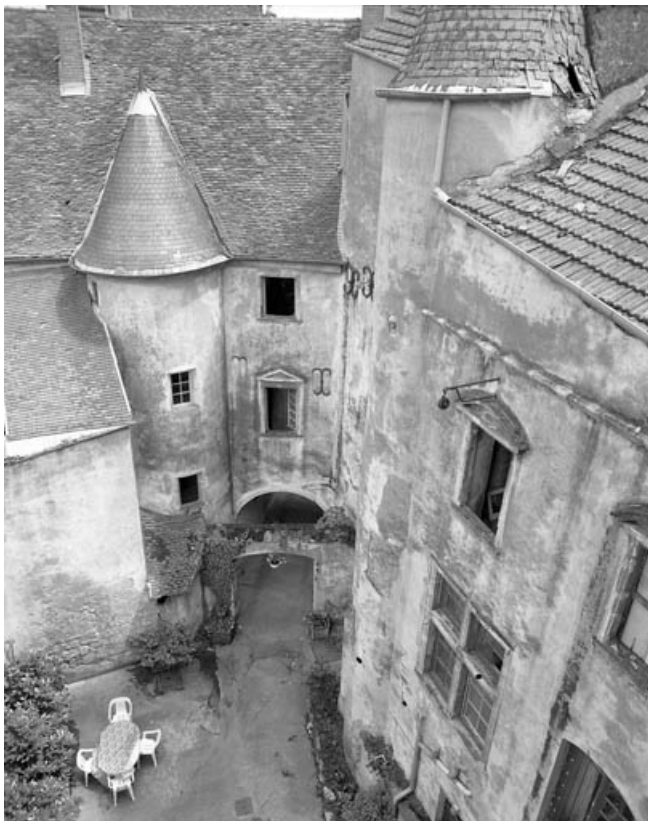
Bâtiment droit : vue plongeante depuis la cellule de saint Pierre Fourier. 70, Gray, 4, 6, 8 rue du Marché
