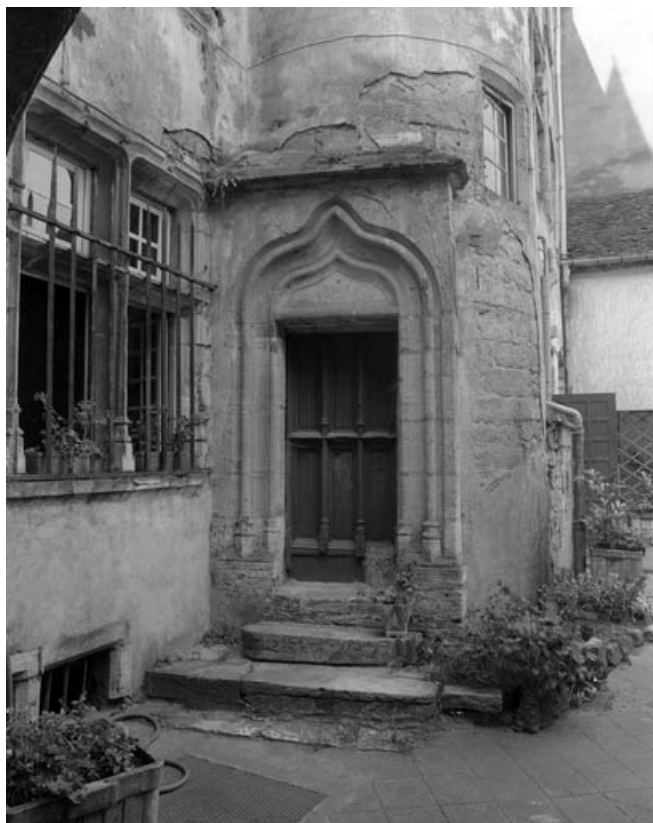
Façade sur cour : partie droite, détail de la porte de l'escalier en vis.
