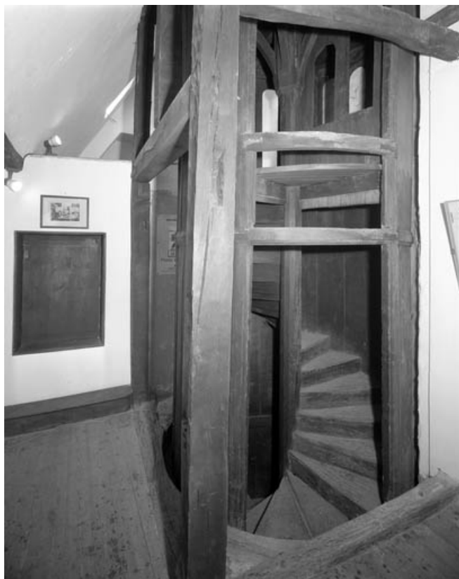
Détail du cylindre pivotant ouvert, au niveau de la cellule de saint Pierre Fourier. 70, Gray, 4, 6, 8 rue du Marché
