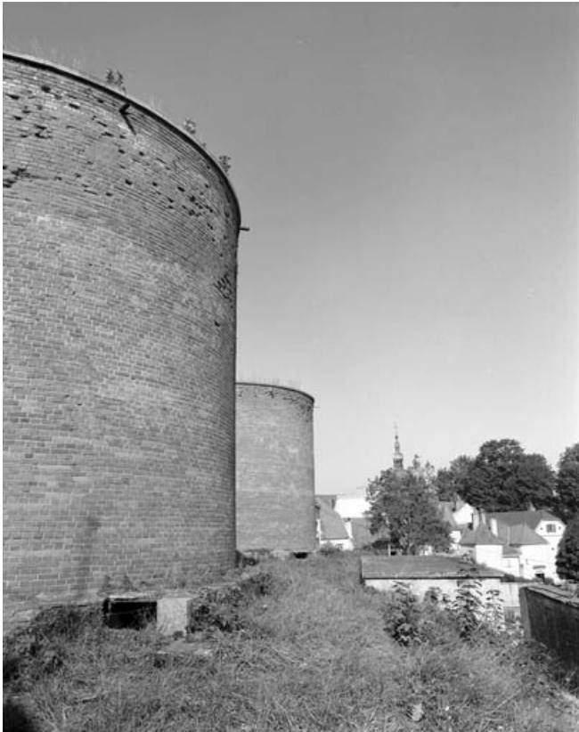
Les réservoirs : vue rapprochée.
