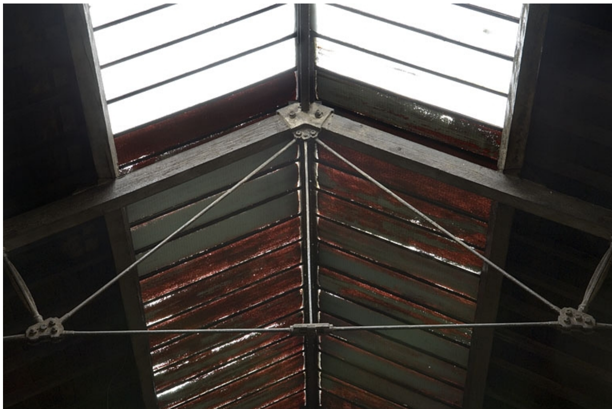
Détail de la charpente Polonceau de l'atelier. 70, Gray, 3 rue de la Plage
