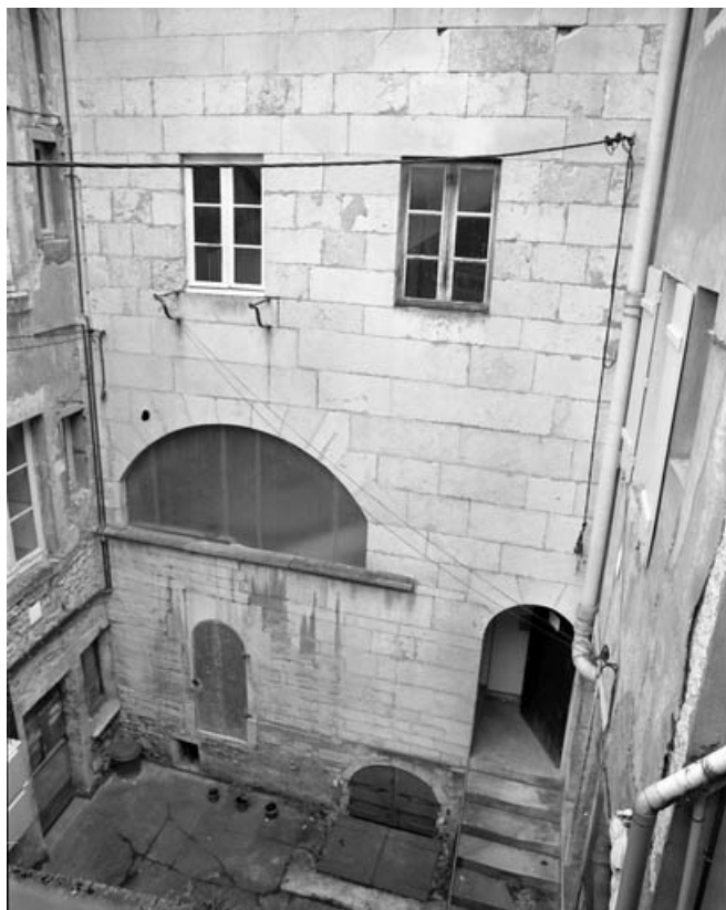
Corps de bâtiment contenant l'escalier : façade antérieure, vue plongeante. 70, Gray, 5 rue Vanoise
