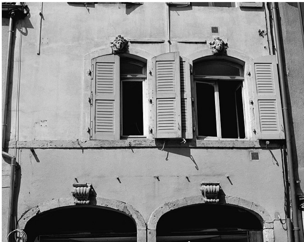
Façade antérieure : détail des clefs d'arcs des baies du rez de chaussée et du premier étage. 70, Gray, 13 rue Vanoise
