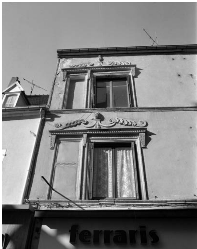
Détail : décor des baies des premier et deuxième étages. 70, Gray Grande Rue 99
