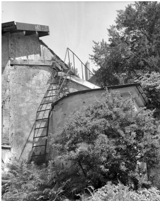
Serre : détail de l'escalier desservant le sommet de l'édifice. 70, Gray, 9 rue Jobard
