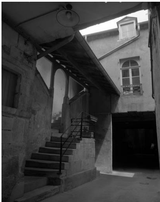
Détail : escalier extérieur situé dans la cour, de trois quarts gauche. 70, Gray Grande Rue 72
