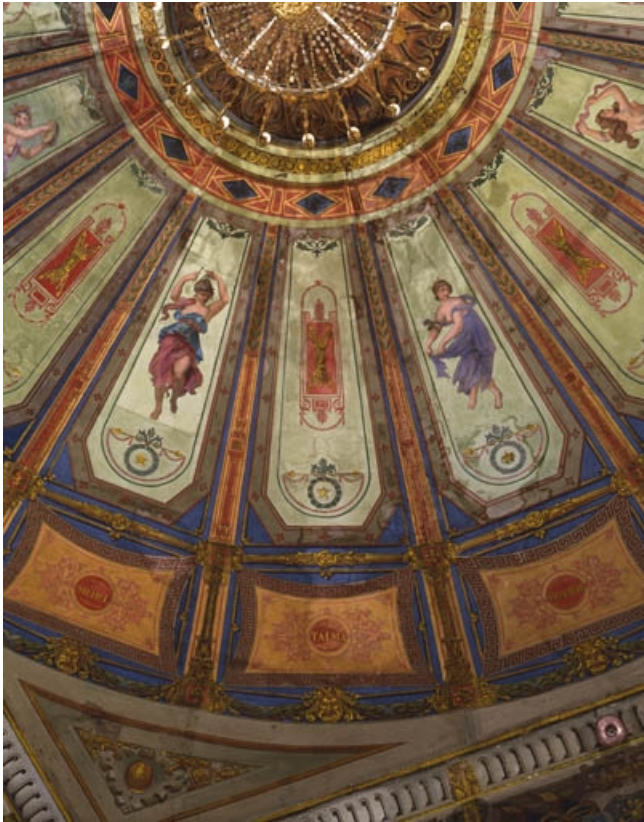
Intérieur : détail du plafond de la salle de spectacle avec deux muses et trois inscriptions (Méhul, Talma, Molière). 70, Gray rue Victor Hugo
